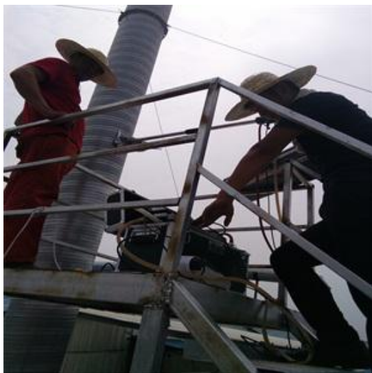
图 4-17 中段 1#、2#、3#热压机废气采样平台
