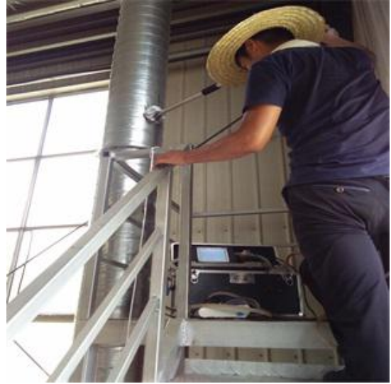
图 4-14 铺板流水线涂胶机采样平台
