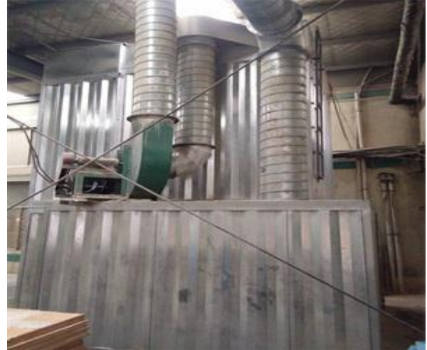
图 4-8 多层二砂工序布袋除尘器
