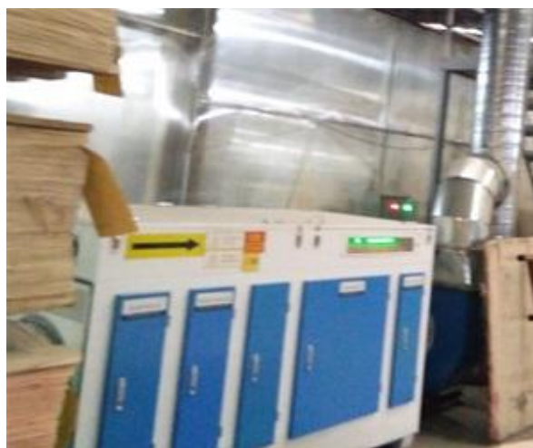
图 4-4 铺板车间涂胶机光催化氧化装置
