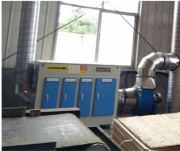
图 4-5 铺板流水线涂胶机光催化氧化装置
