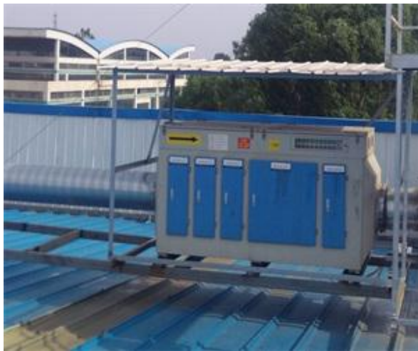
图 4-7 多层板车间 8#~10#热压机光催化氧化装置
