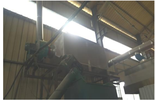
图 4-2 光催化氧化废气治理设施（5#-9#）
