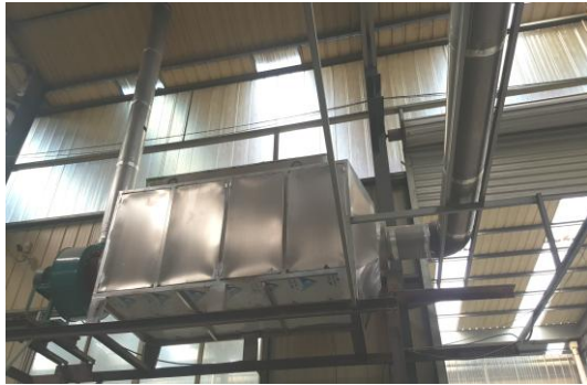
图 4-1 光催化氧化废气治理设施（1#-4#）
