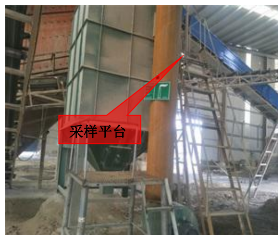
图 7-2 筛分工序废气采样平台
