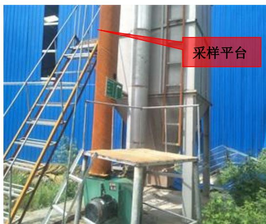
图 7-1 破碎工序废气采样平台
