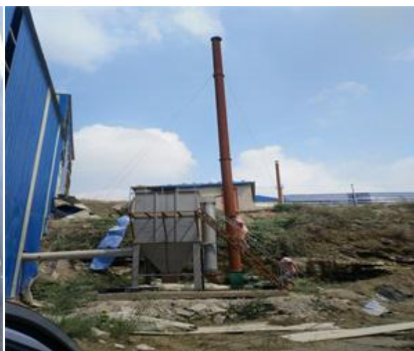
图 3-3 破碎机脉冲布袋除尘器
