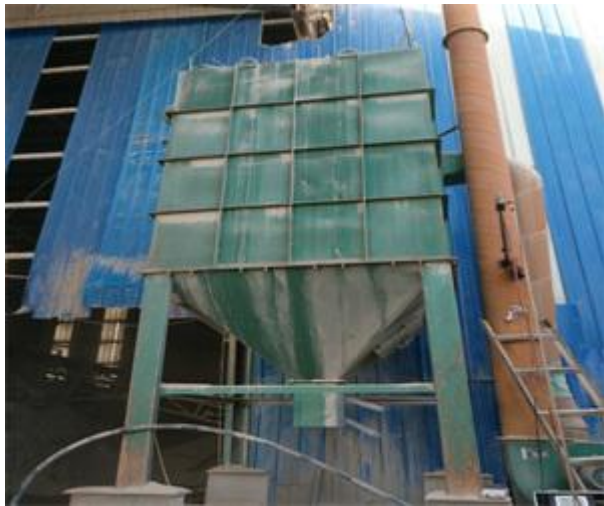
图 3-4 破碎工序布袋除尘器
