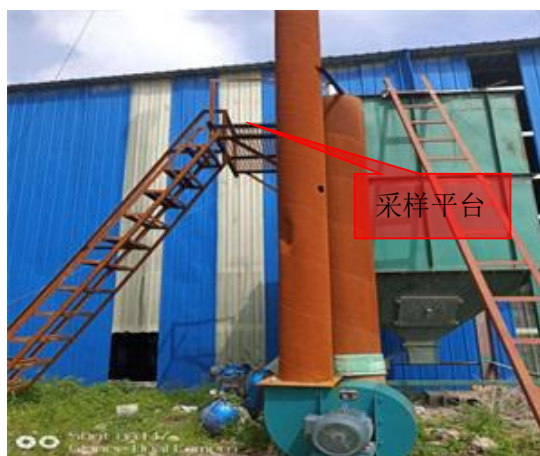
图 7-2 筛分工序废气采样平台
