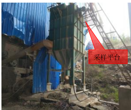
图 7-1 破碎工序废气采样平台
