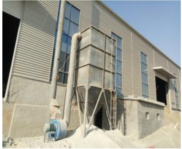
图 3-5 2#锤式破碎机脉冲布袋除尘器
