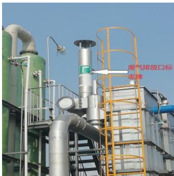
图3 废气排污口标识牌
