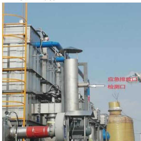
图1 应急排放口、检测口1
