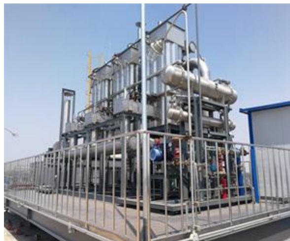
图 4-2 3202 车间废气处理设施
