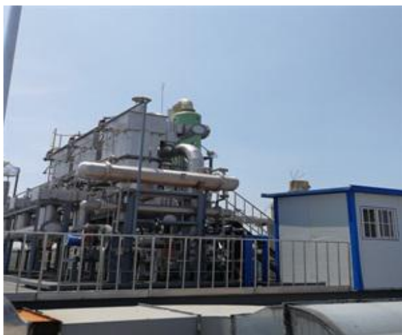
图 4-1 3201 车间废气处理设施
