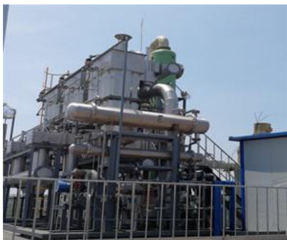
图 3-3 3201 车间废气处理设施
