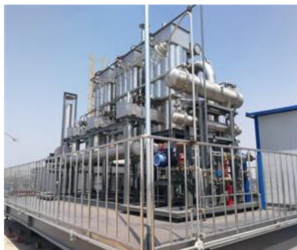
图 3-4 3202 车间废气处理设施
