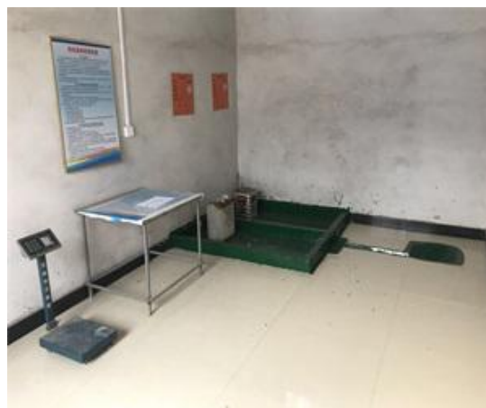
图 4-2 危废库内部防渗
