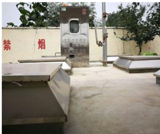
图 4-1 三次油气回收装置
