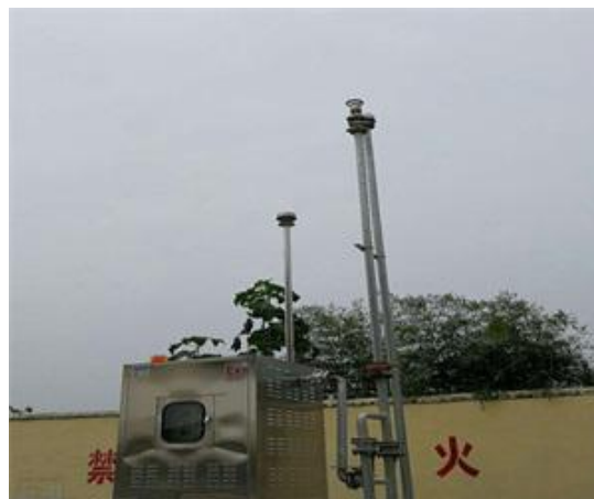
图 4-2 罐区废气排放口
