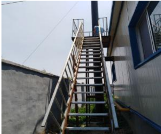
图 4-18 蒸汽锅炉废气采样平台
