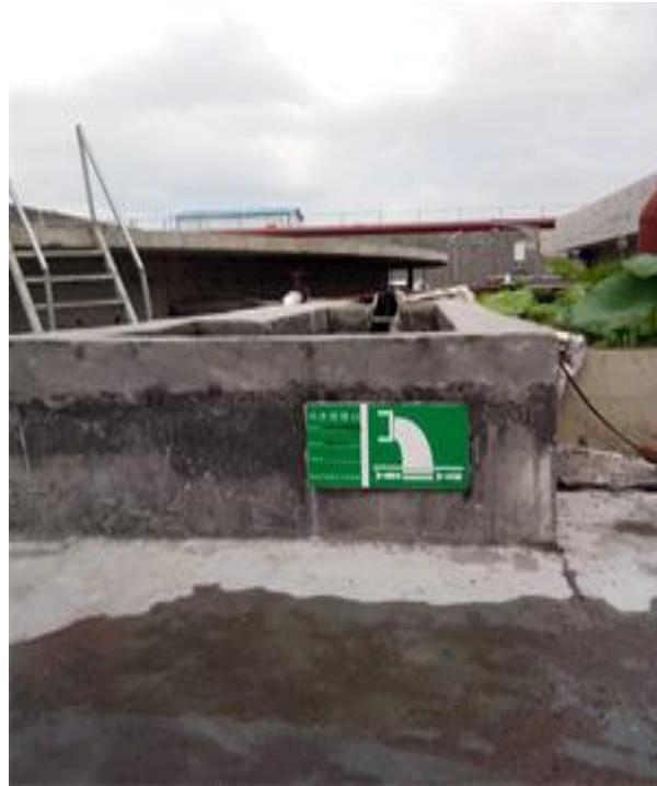
图 4-20 厂区污水排放口
