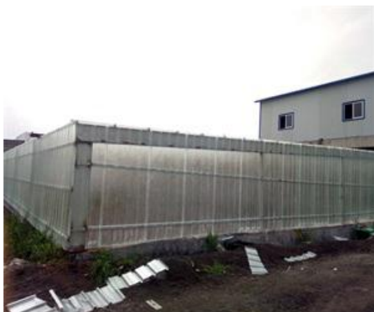
图 4-1 污水处理站收集池全封闭
