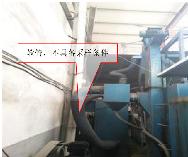
图 6-1 布袋除尘器进口连接管道
