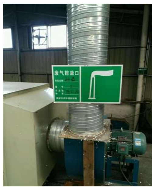
图 7-2 固化工序有机废气排放口
