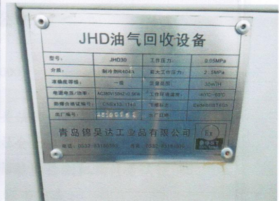
气回收设备铭牌
