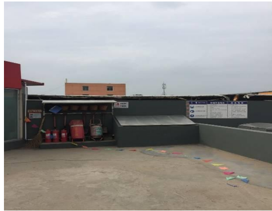
图 4-3 罐区消防器材
