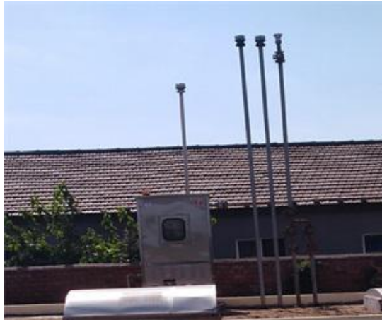
图 4-1 三次油气回收系统
