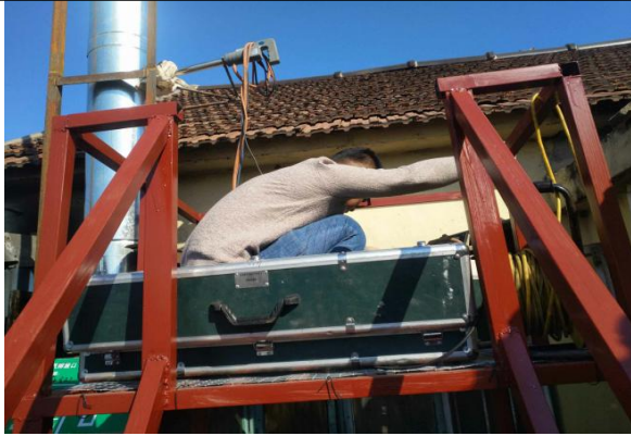
图 4-3 油烟排气筒、采样平台及排污口标识
