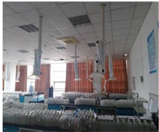
图 4-6 实验室集气管道
