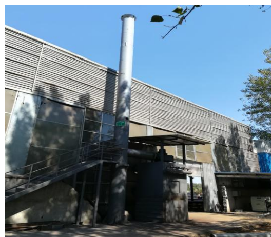
图 4-5 抛丸工序废气排气筒
