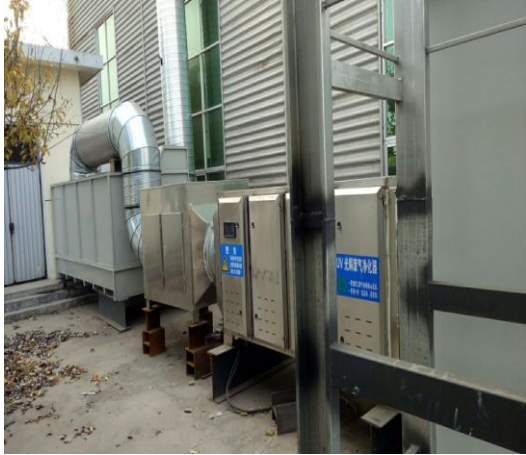
图 4-3 水帘+过滤棉+UV 光解废气净化器
