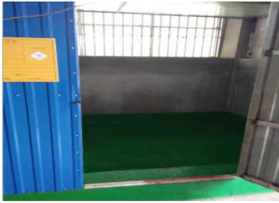
图 4-16 危废库内部情况
