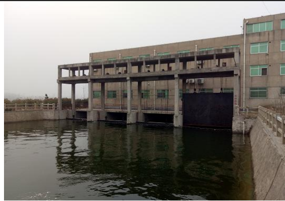
图 4-9 闸门和启闭机
