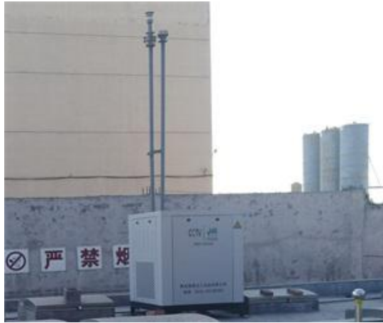
图 4-1 三次油气回收系统
