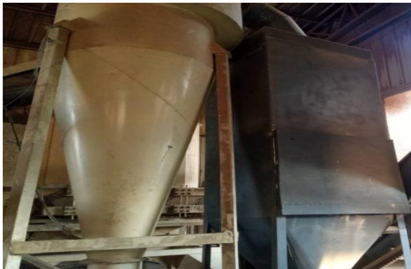
图 4-5 筛分、成品输送旋风除尘器+布袋除尘器
