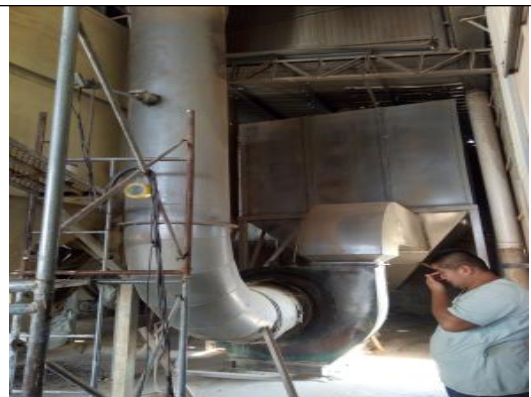
图 4-2 布袋除尘器（烘干、燃烧废气）
