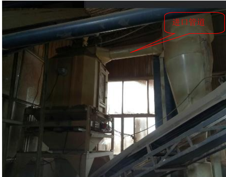
图 7-2 筛分、输送废气处理设施进口管道
