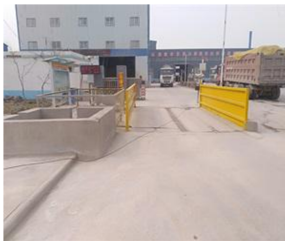
图 4-7 洗车机+二级沉淀池
