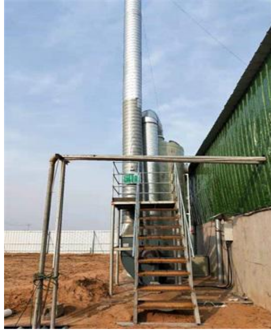
图 4-8 污水站废气采样平台
