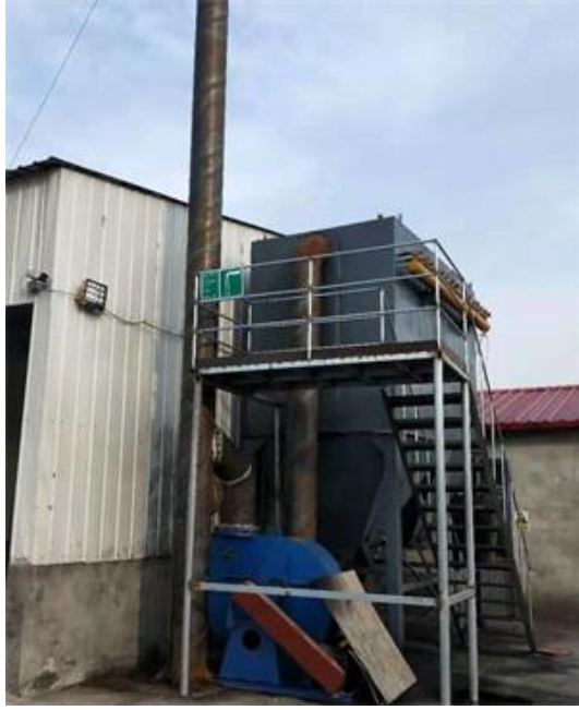
图 4-7 锅炉废气采样平台
