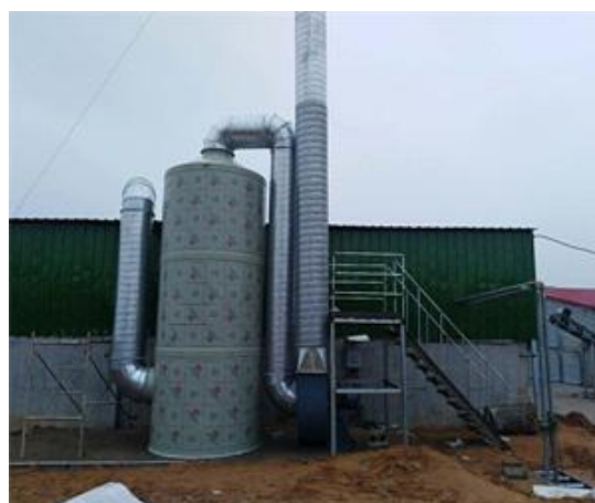
图 4-2 污水处理站废气处理设施
