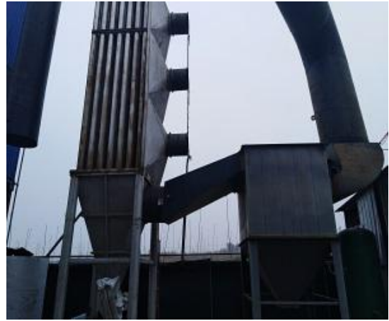
图 4-4 多管陶瓷除尘器+多管冷却塔
