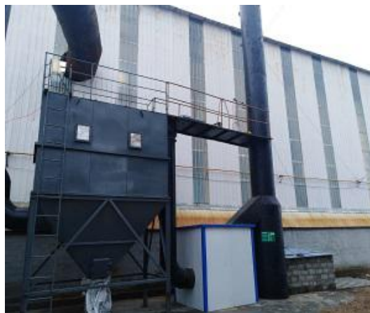
图 4-13 炒灰车间废气采样平台
