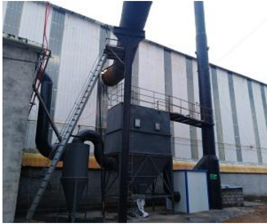
图 4-3 旋风除尘器+脉冲布袋除尘器+排气筒
