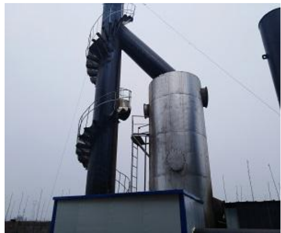
图 4-6 碱液喷淋塔+排气筒
