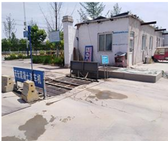
图 4-5 洗车机+二级沉淀池
