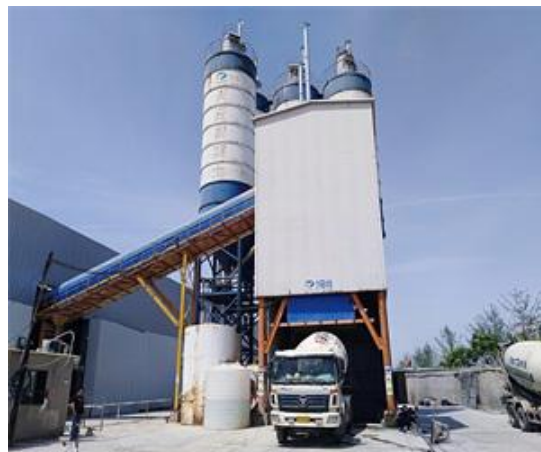
图 3-4 混凝土搅拌站
