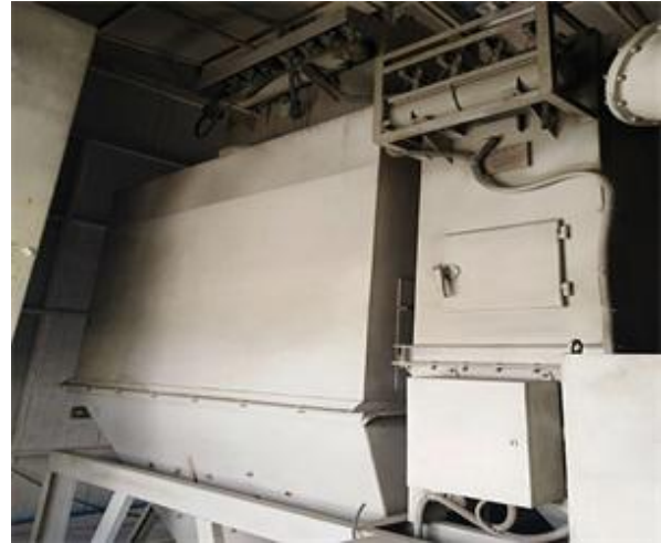
图 4-2 搅拌机投料工序布袋除尘器
