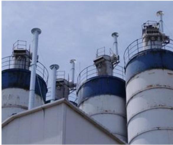
图 4-1 仓顶布袋除尘器
