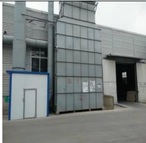
图 4-9 布袋除尘器及排气筒
