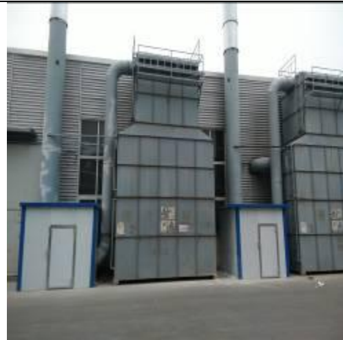
图 4-11 布袋除尘器及排气筒
