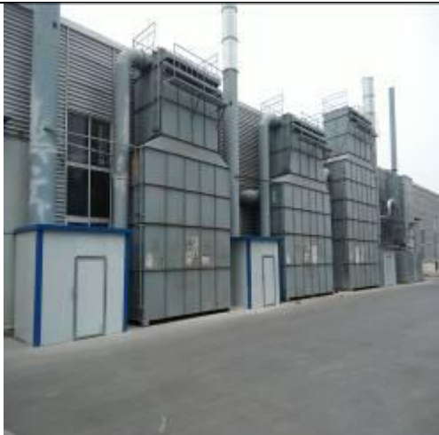
图 4-8 布袋除尘器及排气筒
