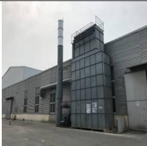
图 4-10 布袋除尘器及排气筒
