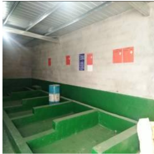
图 4-20 危险废物暂存区内部
