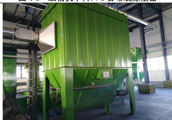
图 4-8 密炼机落料口布袋除尘器
