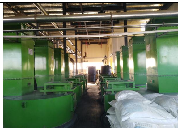
图 4-6 上辅机下料口 8 台布袋除尘器
