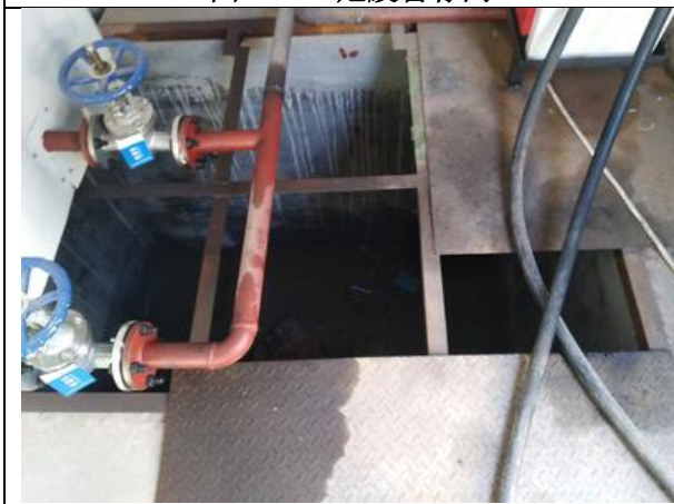
图 4-23 芳烃油罐车间集液槽
