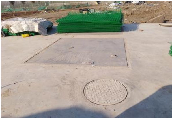
图 4-19 地埋式一体化污水处理站
