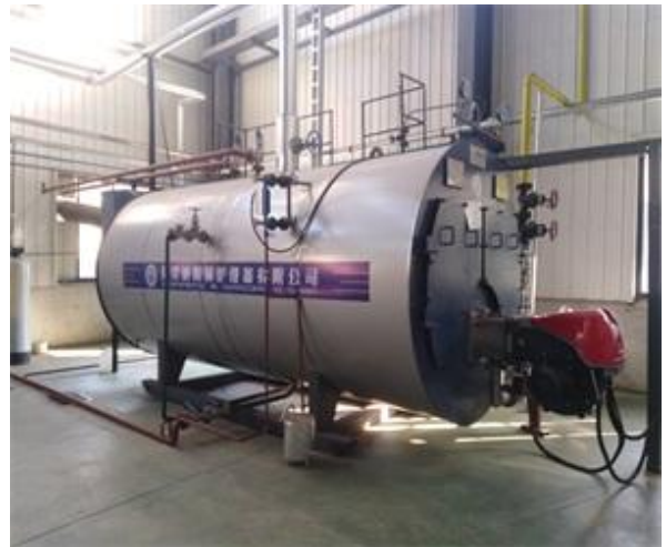
图 3-14 燃气锅炉（备用）
