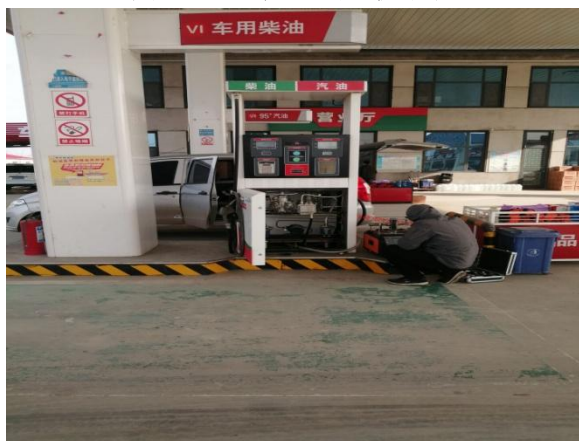
图 4-3 二次油气回收系统
