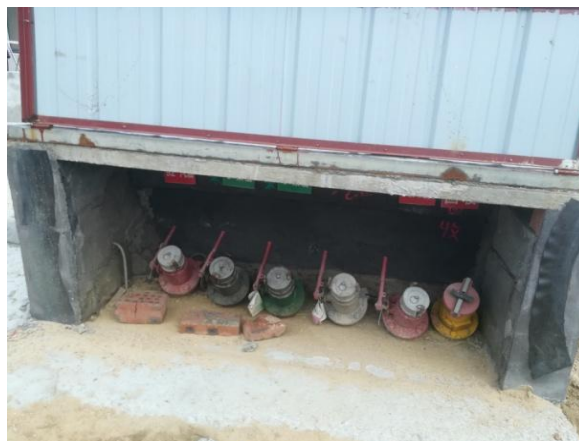
图 4-2 卸油口及一次油气回收系统
