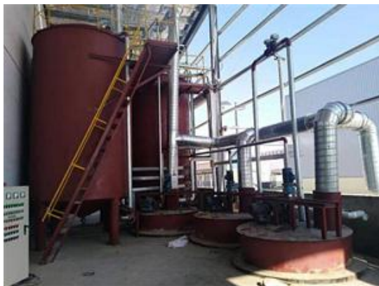
图 3-5 混料槽、化料槽
