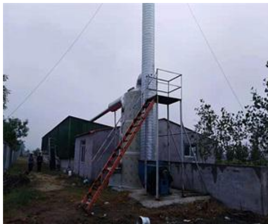
图 4-1 污水处理站废气处理设施
