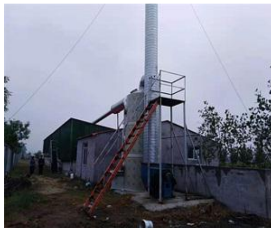
图 4-6 污水站废气采样平台
