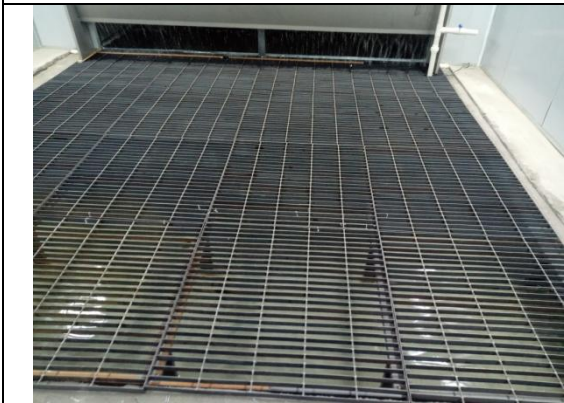
图 4-7 絮凝剂沉淀池
