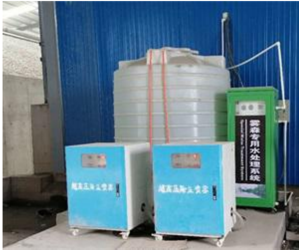
图 4-5 车间水喷淋系统
