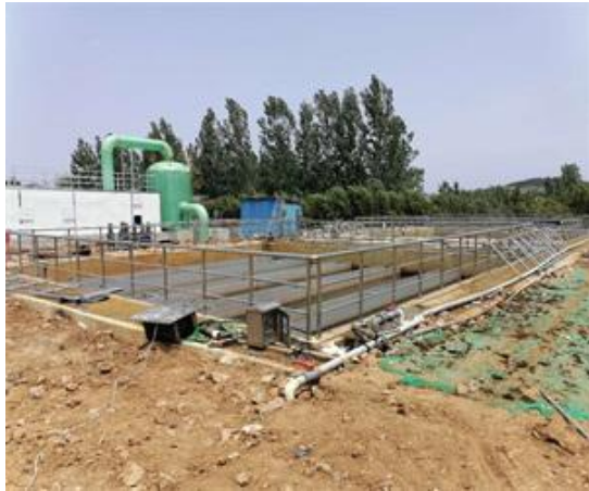
图 3-10 一期絮凝沉淀池
