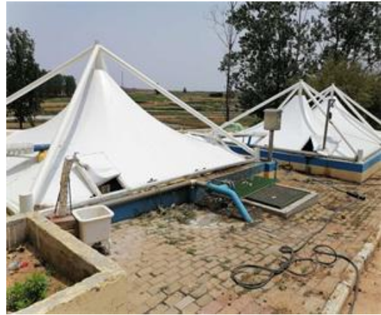
图 3-15 二期污泥均质池
