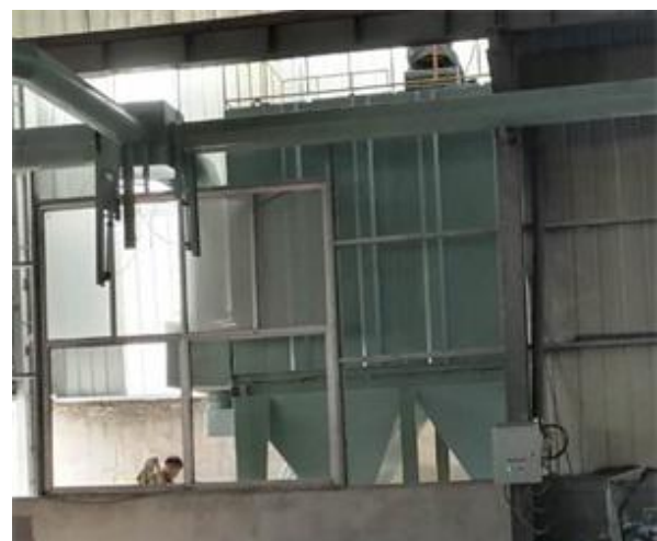
图 4-4 电炉及混砂机用布袋除尘器
