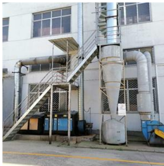
图 4-6 2#车间注射线废气采样平台
