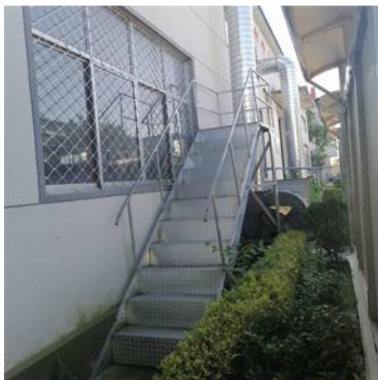
图 4-5 1#车间注射线有机废气采样平台
