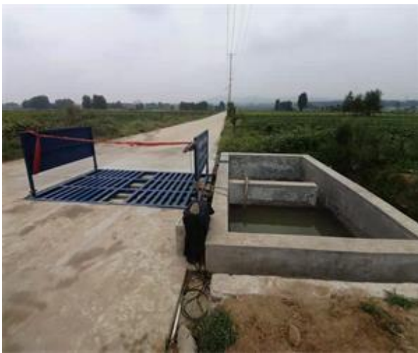
图 5-5 洗车机及沉淀池
