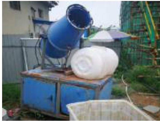
图 8-2 厂界喷雾设施
