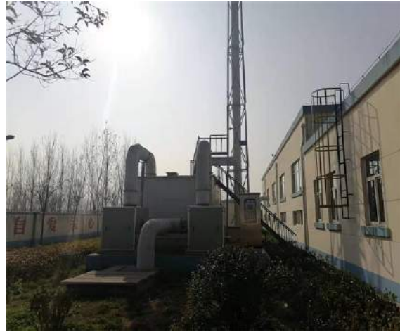
图 4-2 废气处理设施 (2#)
