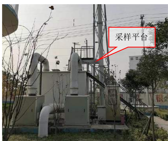
图 4-7 废气采样平台
