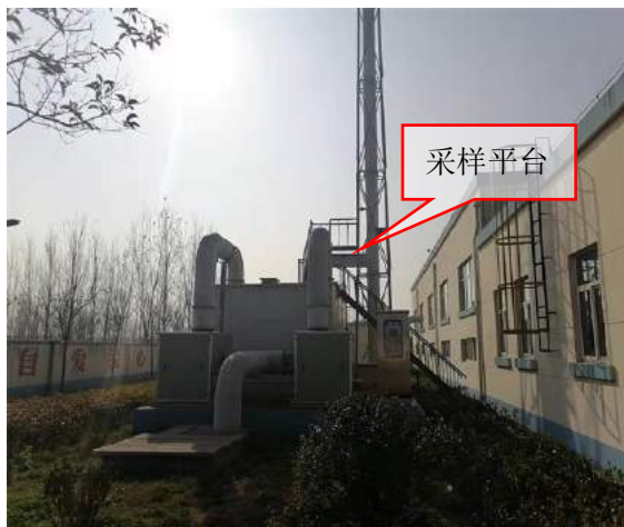
图 4-8 废气采样平台
