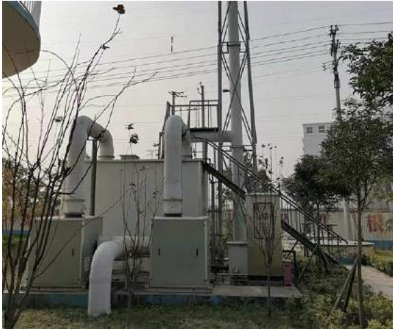
图 4-1 废气处理设施 (1#)
