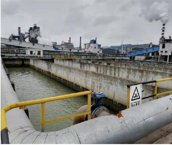
图 4-9 山东国铭球墨铸管科技有限公司 污水处理站
