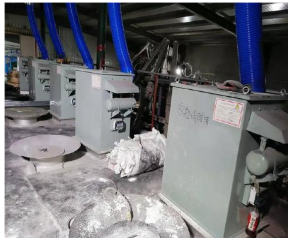
图 4-4 上辅机自带除尘器
