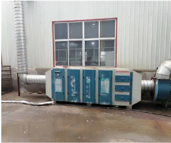
图 4-3 生产区废气处理设施
