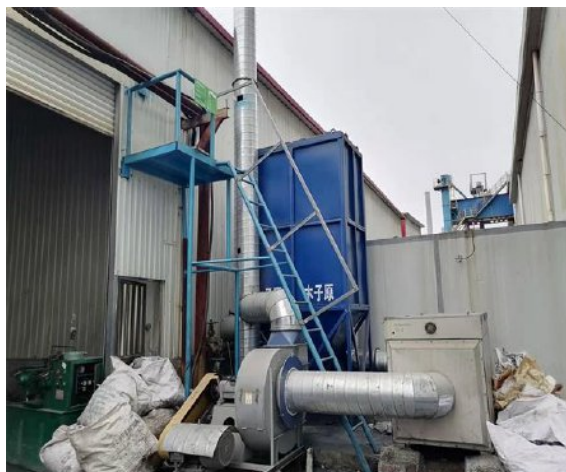
图 4-1 炼胶区废气处理设施
