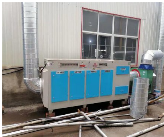
图 4-2 生产区废气处理设施
