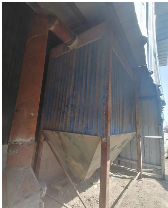
图 4-1 投料工序除尘器
