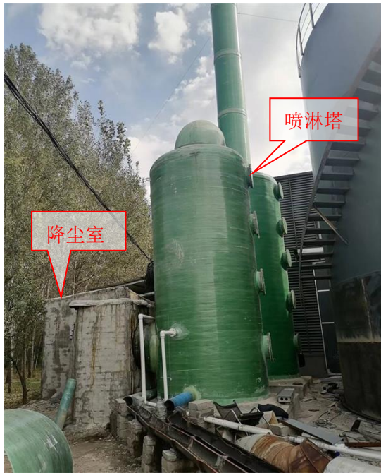
图 4-3 烘干工序降尘室+喷淋塔
