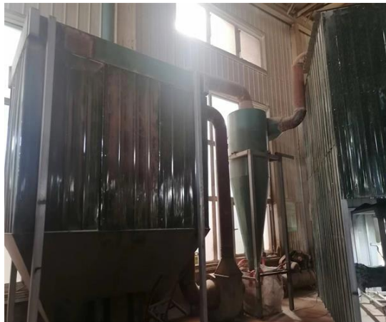
图 4-5 包装工序旋风除尘器+袋式除尘器
