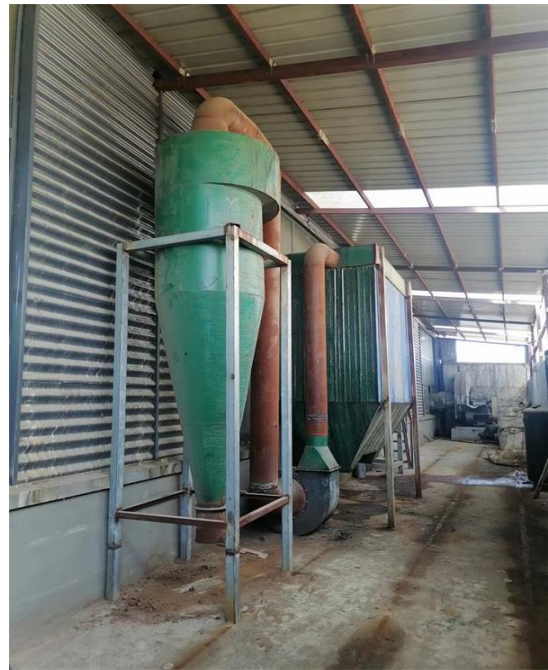
图 4-4 风冷工序旋风除尘器+袋式除尘器
