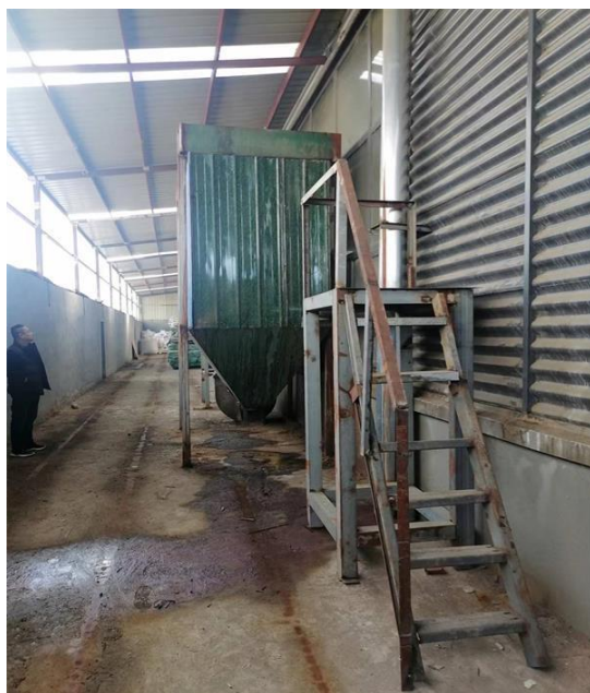
图 4-9 风冷工序废气采样平台
