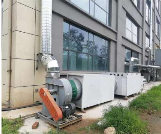
图 4-3 干式过滤器+活性炭吸附+UV 光催化 氧化+活性炭吸附装置
