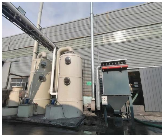
图 4-2 布袋除尘器、两级喷淋塔
